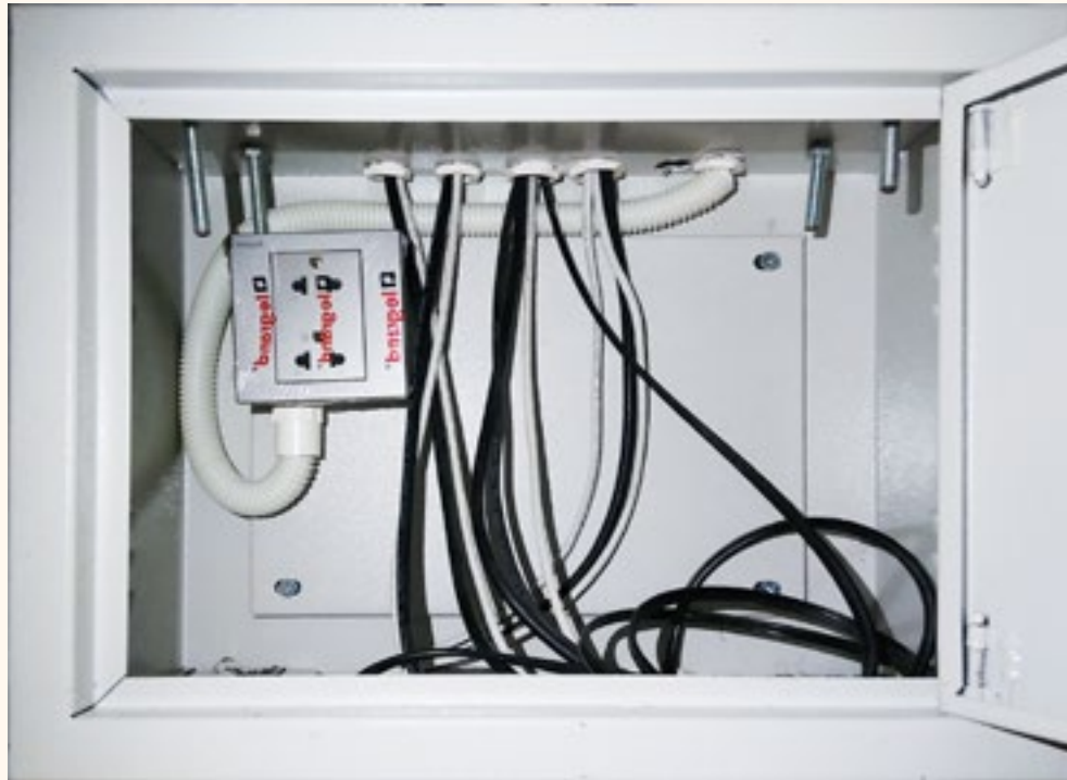
Tủ điện nhẹ căn hộ
