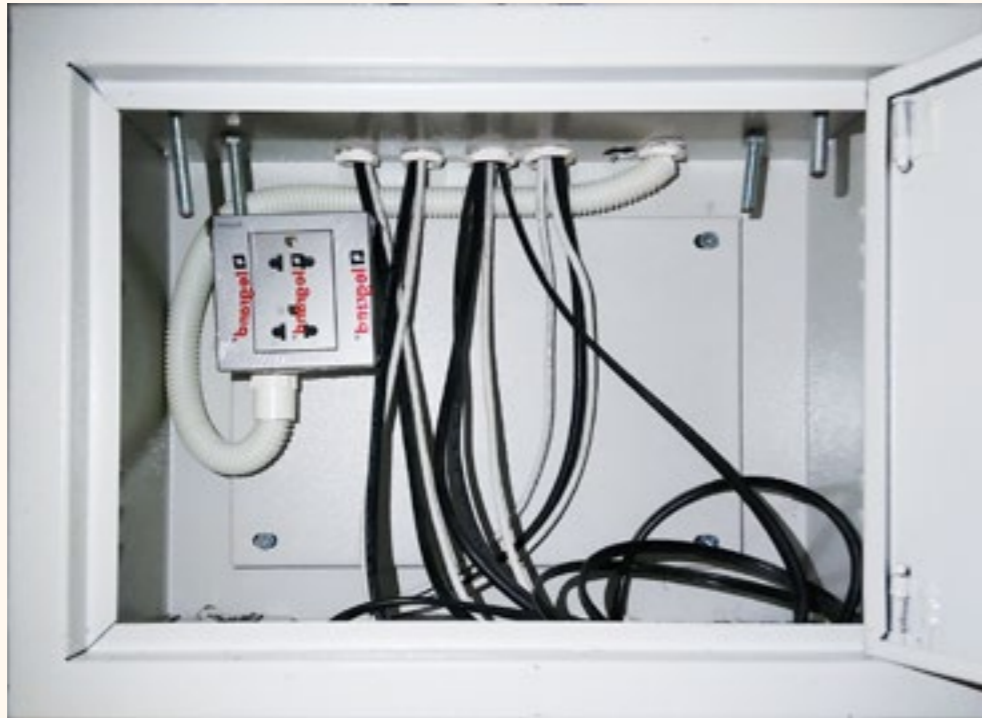
Tủ điện nhẹ căn hộ
